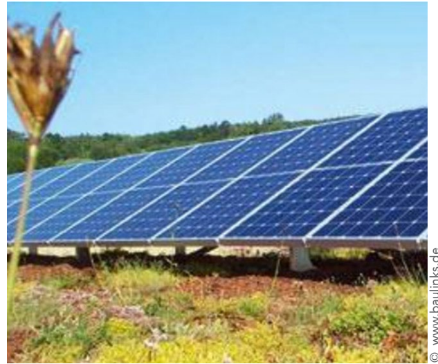
Begrünte Dächer erhöhen durch Kühlung den Wirkungsgrad der Solaranlage.
